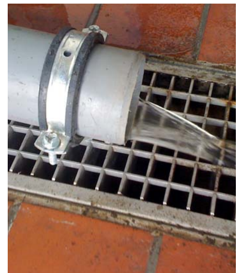
PROBEBETRIEB: Filtratablauf in der Befüllungsphase von zwei Filtersäcken im Rechengebäude der KA
