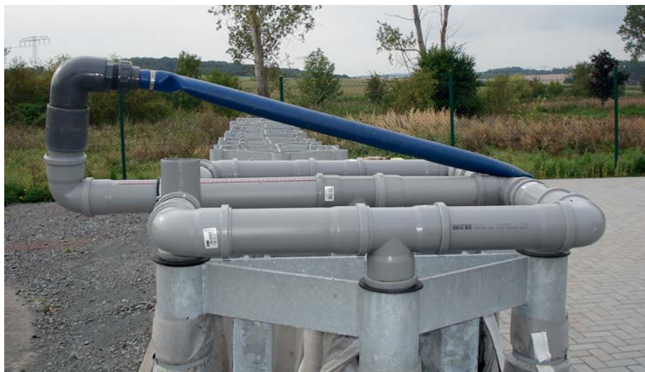
Entwässerungsgestell für die gleichzeitige Befüllung aller Filtersäcke – Gestelloberteil mit HT-Rohrformstücken zur Schlammverteilung
